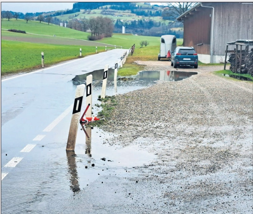
Die nicht mehr funktionstüchtige Entwässerung auf der Buholzstrasse – im Bild eine Aufnahme vom Januar 2025 – führt immer wieder zu gefährlichen Verkehrssituationen.
